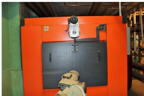
Abb. 16: Kessel der Nahwärme Oberhofen am Irrsee (KEM MONDSEELAND 2016).
