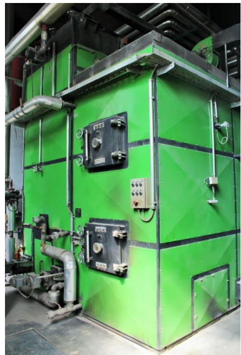
Abb. 13: Kessel der Fernwärme Zell am Moos (KEM MONDSEELAND 2016).
