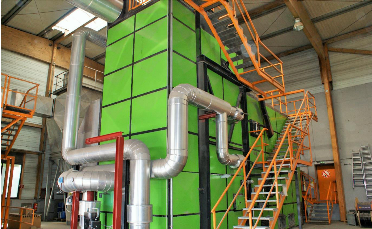
Abb. 12: Kessel der HW Mondsee (Quelle: KELAG WÄRME GMBH 2016).
